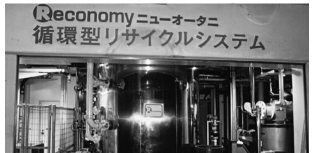
循環型リサイクルシステムの内部
